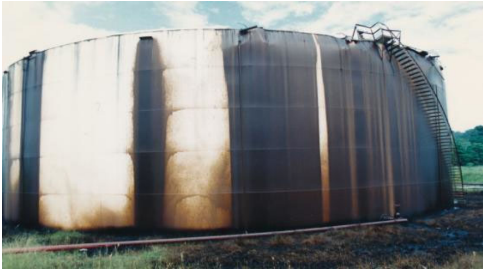
Ballotement du liquide Réservoir 44m \Phi
